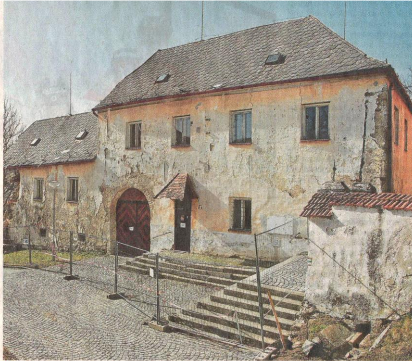
Pokrok Spolku, který usiluje o záchranu fary, se podařilo zajistit bortící se část jedné z budov podle návodu statika. Uvolnil tak i přilehlou silnici pro provoz. Foto: Petr Lundák, MAFRA
